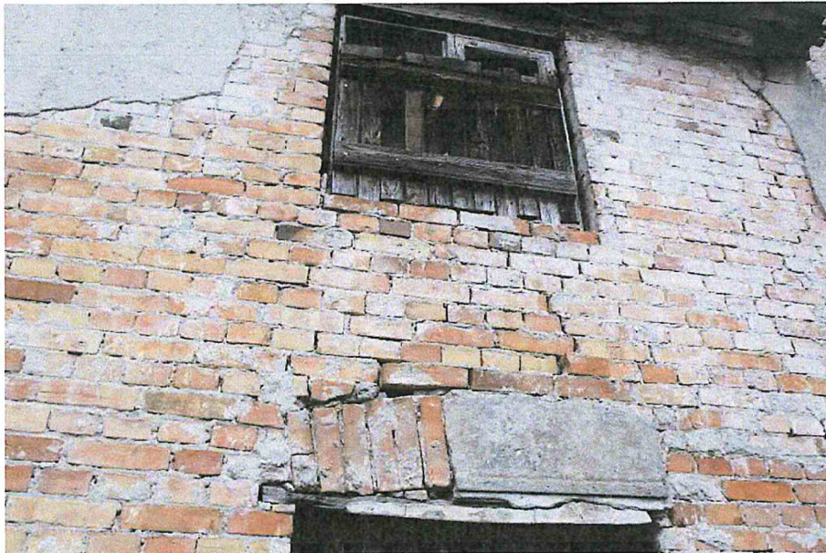
Ansicht massive Rissbildung im Mauerwerk
