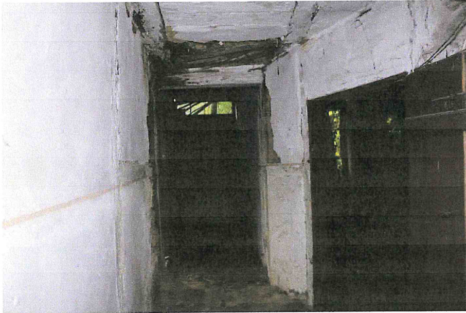
zerstörter Deckenbereich durch Holzfäule
