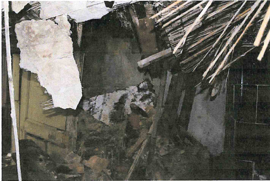
Massive Fäule ist auf den Platten und der Balkenlage erkennbar.
