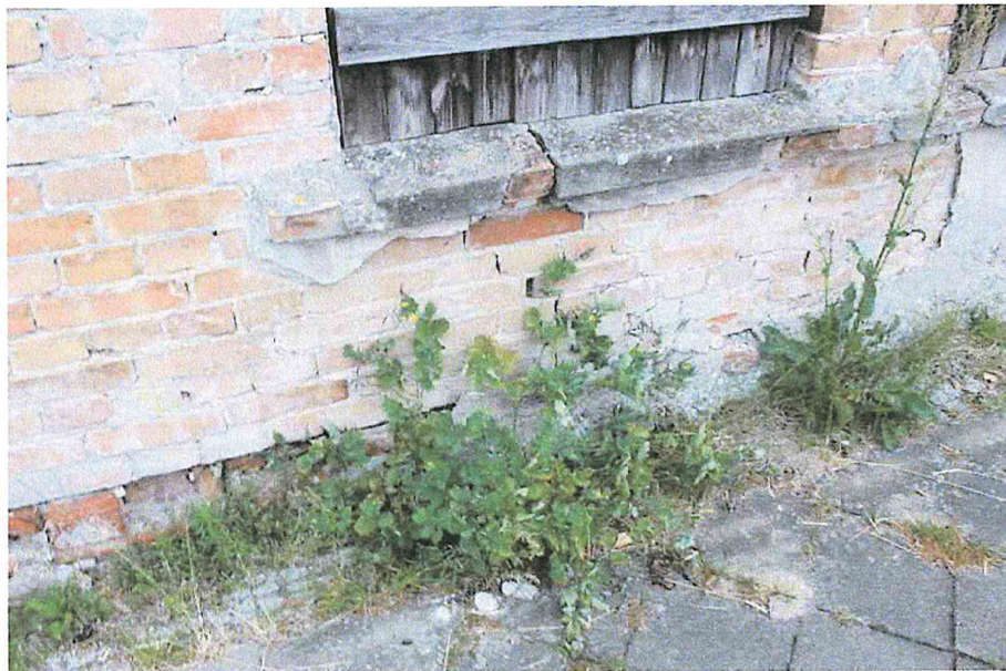
Riss unterhalb des Fensters
